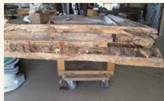
Veduta delle ante dei portoni dal basso, si vede in particolare il degrado del legno dovuto all'attacco degli micro-organismi marini
