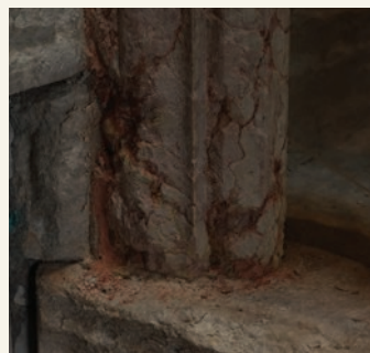
Particolare del degrado del calcare ammonitico "rosso Verona"
