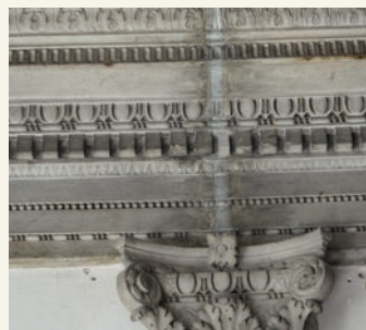
Particolare delle morfologie di degrado che interessano gli apparati lapidei
