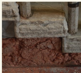
Particolare del degrado del calcare ammonitico "rosso Verona"
