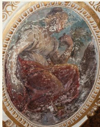
Particolare di uno dei dipinti murali con evidenza delle morfologie di degrado presenti
