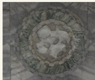
Particolare di una patera antica in marmo cristallino con fenomeni avanzati di degrado
